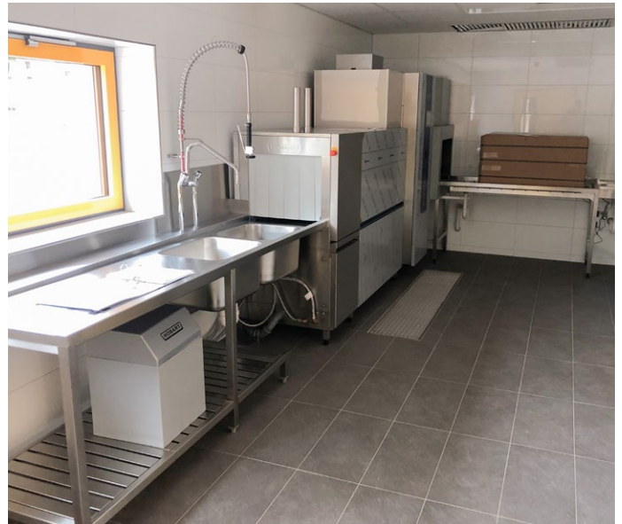
Kastentransportmaschine, Spülküche mit ausreichender Stellfläche
